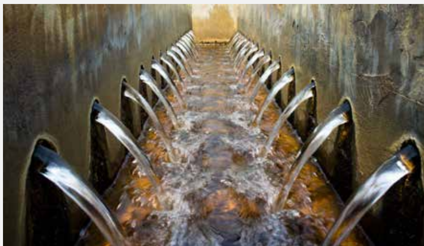
Équipements d'une station d'épuration © Alliance Environnement
